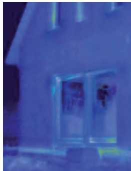
Fotos einer Wärmebildkamera. Links vor und rechts nach Austausch der Fenster.
